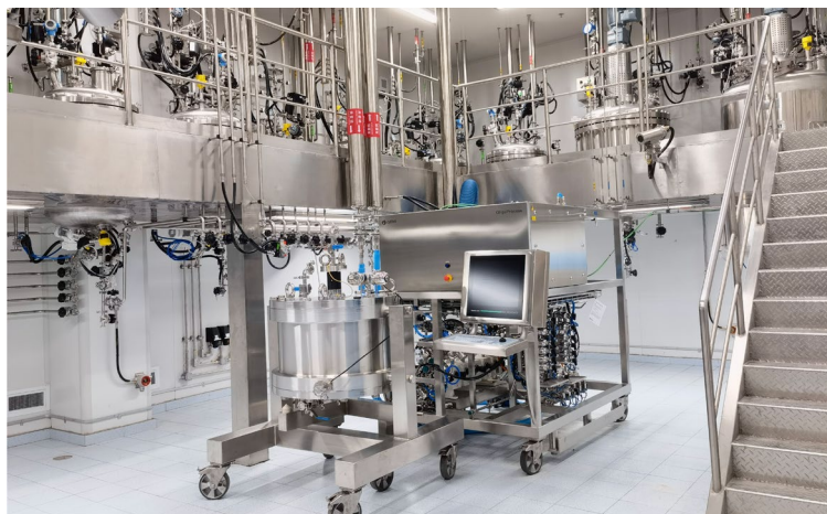
常州基地寡核苷酸生产车间1800毫摩尔合成仪（图片来源：合全药业）
